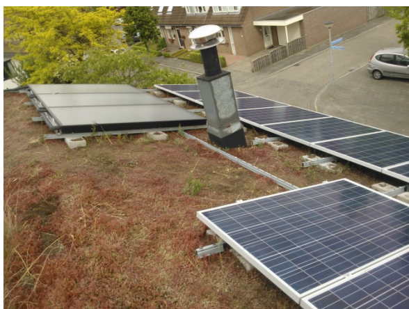
drie zonnecollectoren links met de zonnepanelen op /in het sedemdak geplaatst.
