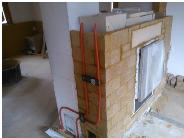
de leemkachel met warmtewisselaar in aanbouw. Vermogen 3.5 Kw.
